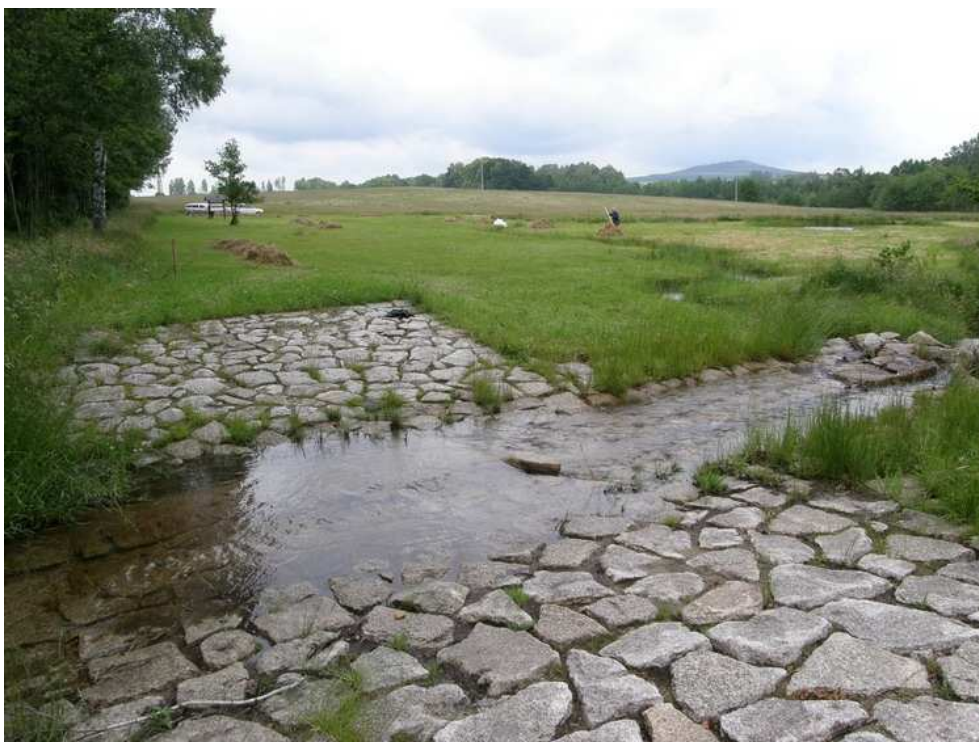
Obr. 4 Rozdělovací objekt na Holubím potoce, včetně zachycené péče o travní porosty (foto: Fialová, 2009)
